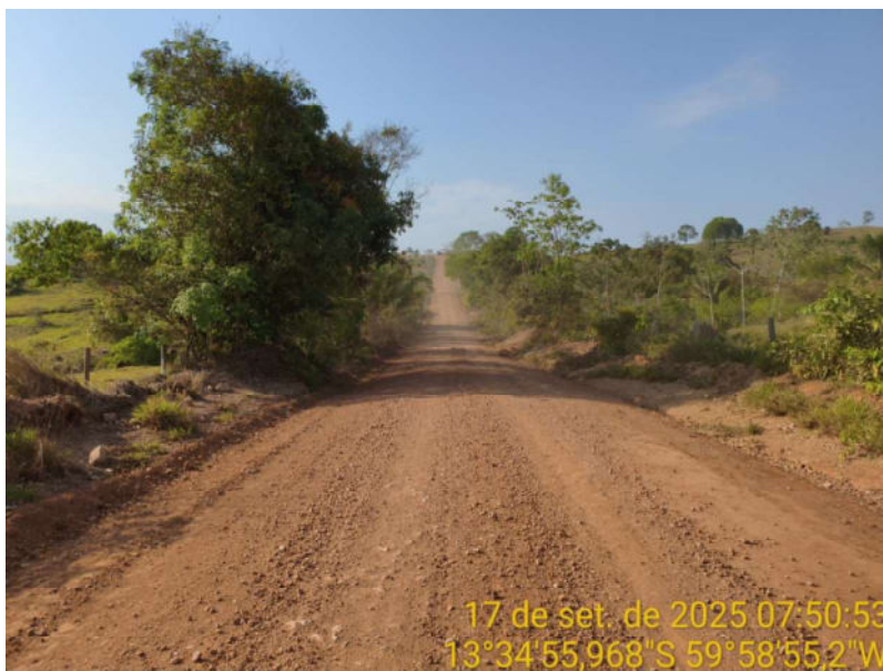
Foto 99 – Trecho não pavimentado da MT-440.
