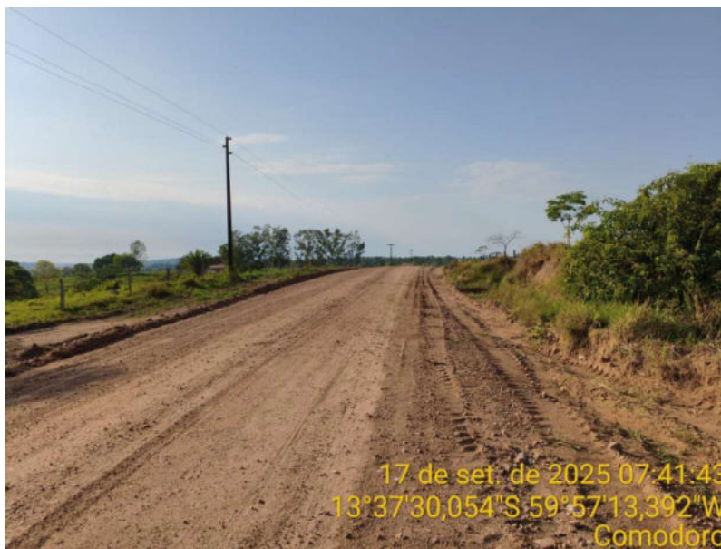
Foto 95 – Trecho não pavimentado da MT-440.
