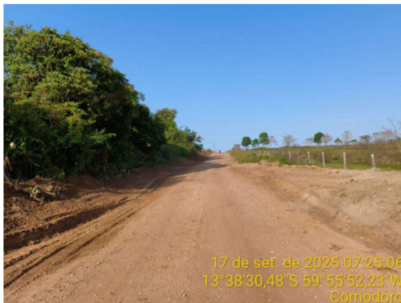
Foto 89 – Trecho não pavimentado da MT-440.
