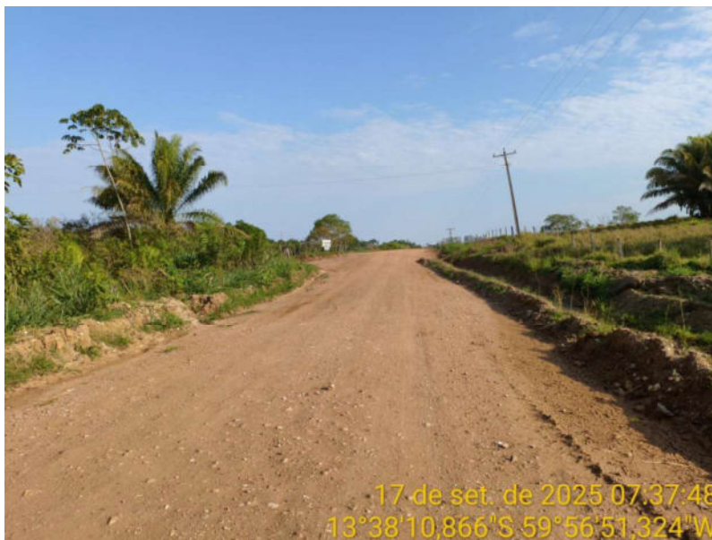
Foto 94 – Trecho não pavimentado da MT-440.
