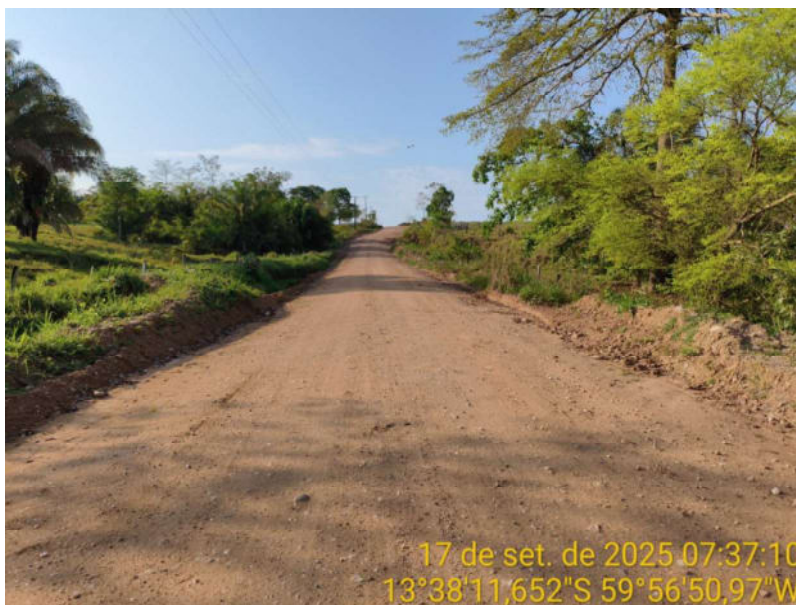
Foto 93 – Trecho não pavimentado da MT-440.
