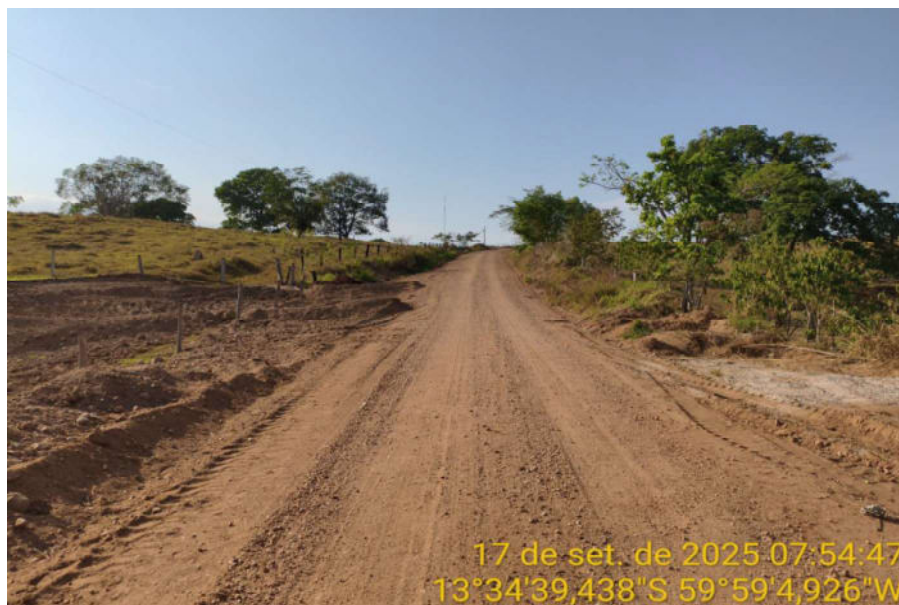
Foto 100 – Trecho não pavimentado da MT-440.
