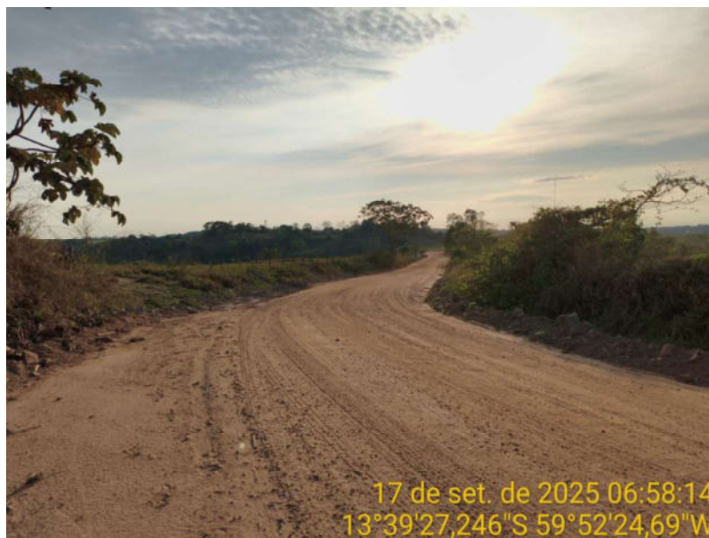
Foto 83 – Trecho não pavimentado da MT-440.
