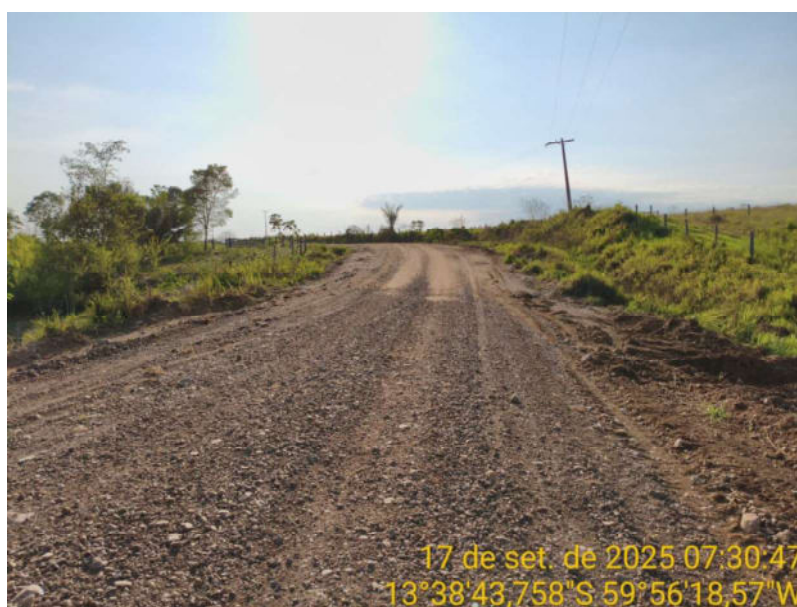
Foto 91 – Trecho não pavimentado da MT-440.
