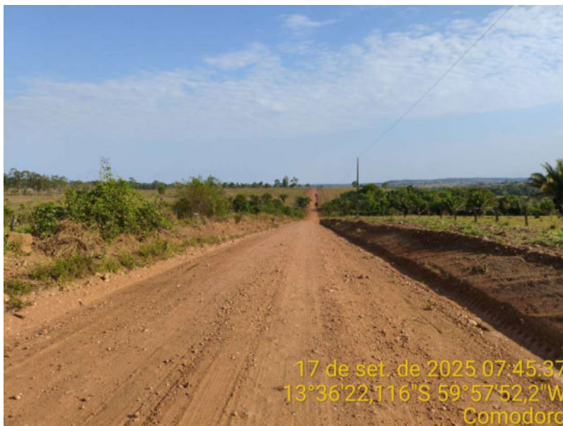
Foto 98 – Trecho não pavimentado da MT-440.
