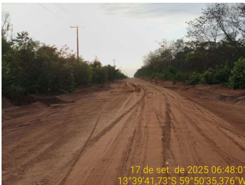
Foto 79 – Trecho não pavimentado da MT-440.
