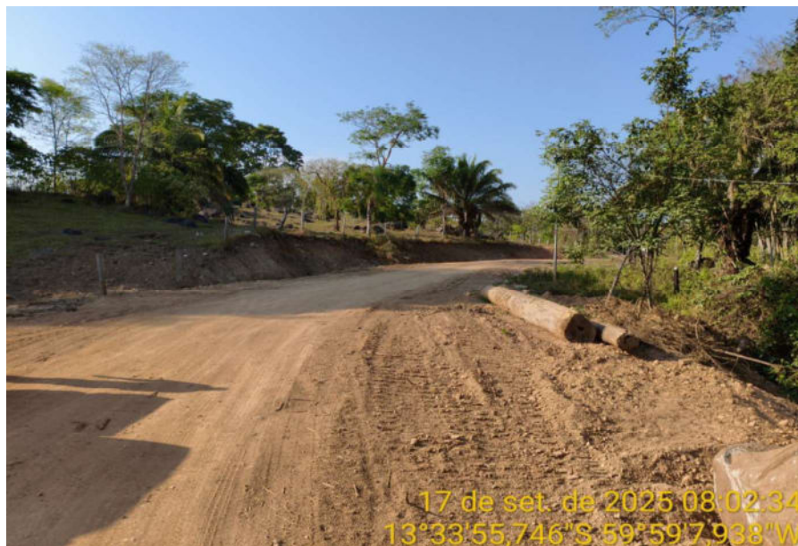
Foto 101 – Trecho não pavimentado da MT-440.
