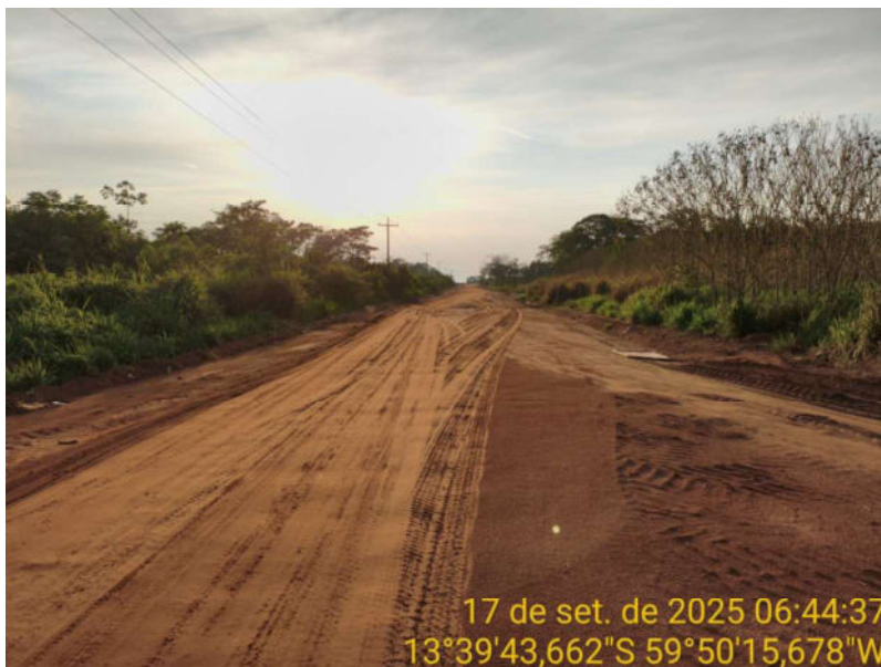
Foto 78 – Trecho não pavimentado da MT-440.
