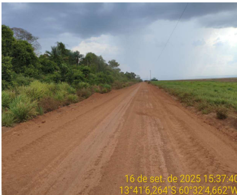
Foto 75 – Fim do trecho não pavimentado de MT-235.
