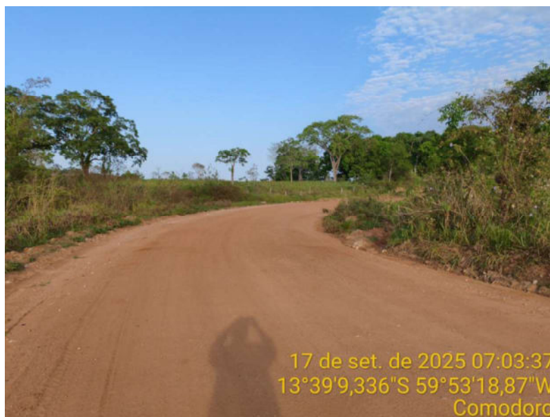
Foto 85 – Trecho não pavimentado da MT-440.
