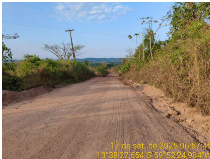
Foto 82 – Trecho não pavimentado da MT-440.
