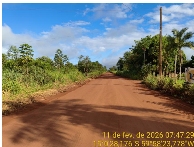
Foto 70 – Trecho não pavimentado da MT-199.
