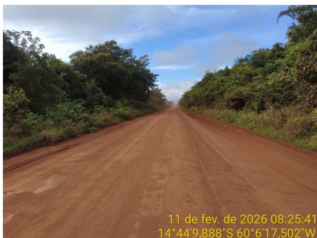
Foto 75 – Trecho não pavimentado da MT-199.
