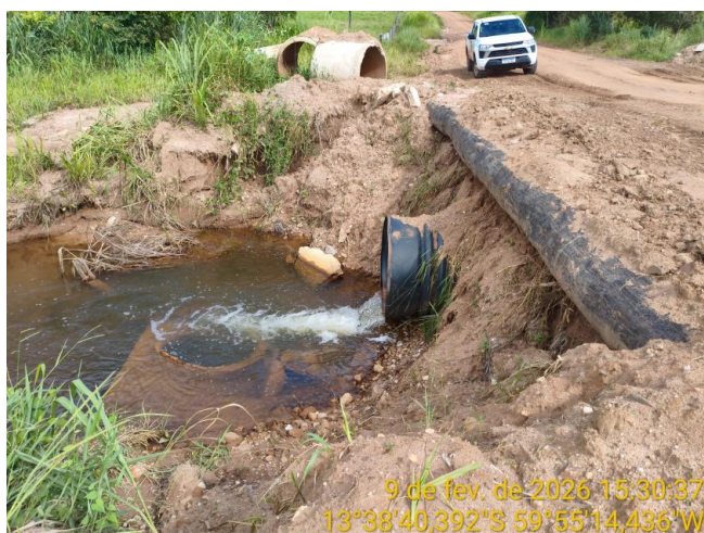
Foto 42 – Bueiro 04 (danificado) na MT-440. Identificado no dia da Vistoria
