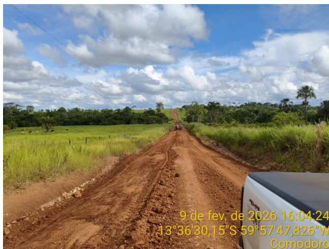
Foto 59 – Trecho não pavimentado de MT-440.
