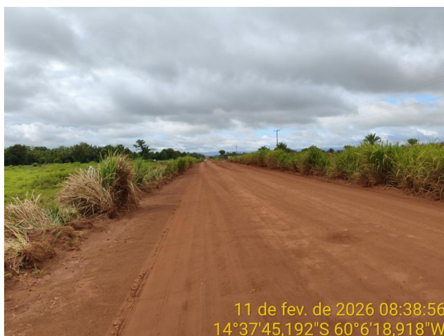
Foto 77 – Trecho não pavimentado da MT-199.
