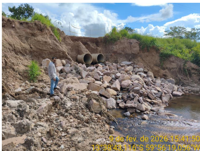
Foto 48 – Bueiro 07 (danificado) na MT-440 (Identificada na vistoria em loco).
