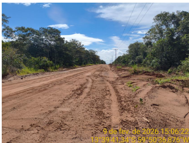
Foto 37 – Trecho não pavimentado de MT-240.
