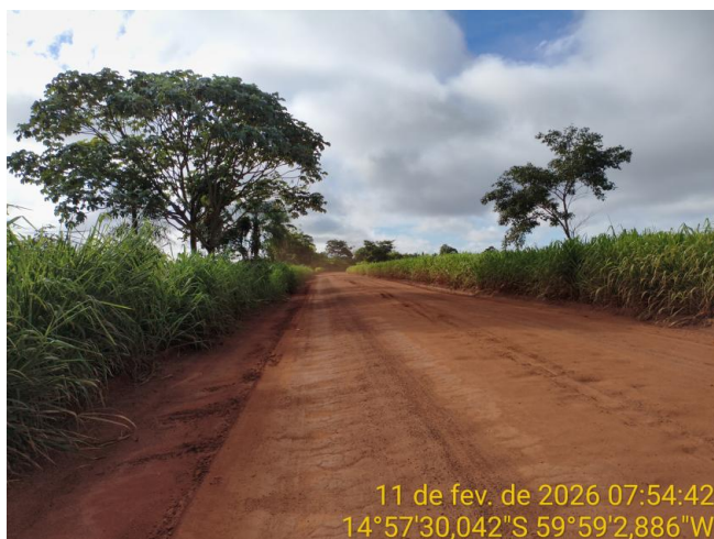
Foto 71 – Trecho não pavimentado da MT-199.
