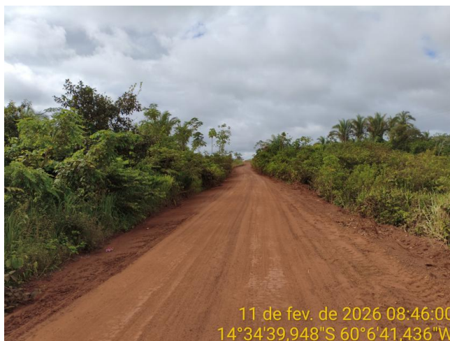
Foto 79 – Trecho não pavimentado da MT-199.
