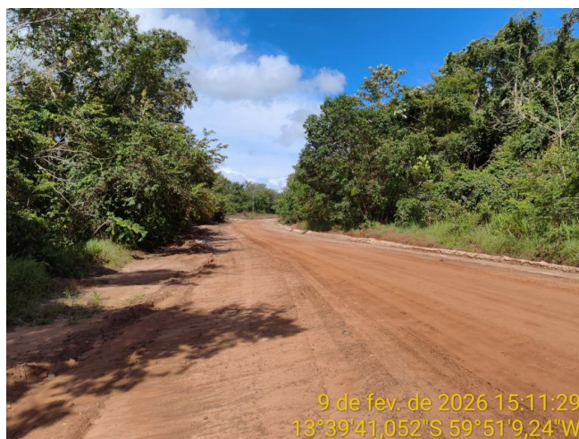
Foto 40 – Trecho não pavimentado de MT-440.
