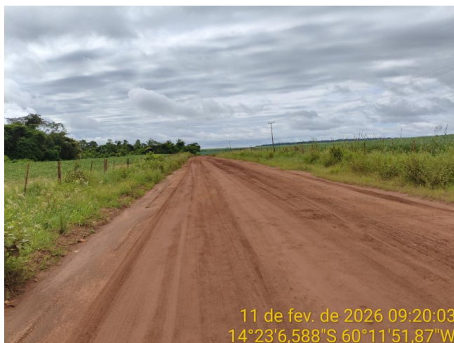
Foto 82 – Trecho não pavimentado da MT-199.
