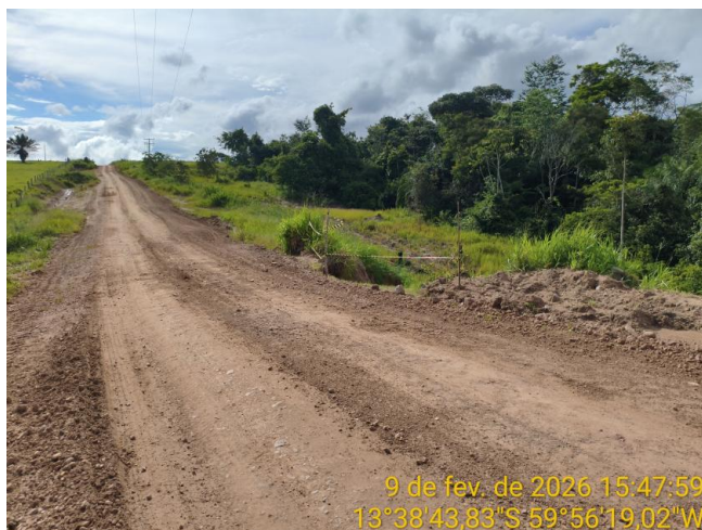
Foto 53 – Trecho não pavimentado de MT-240.
