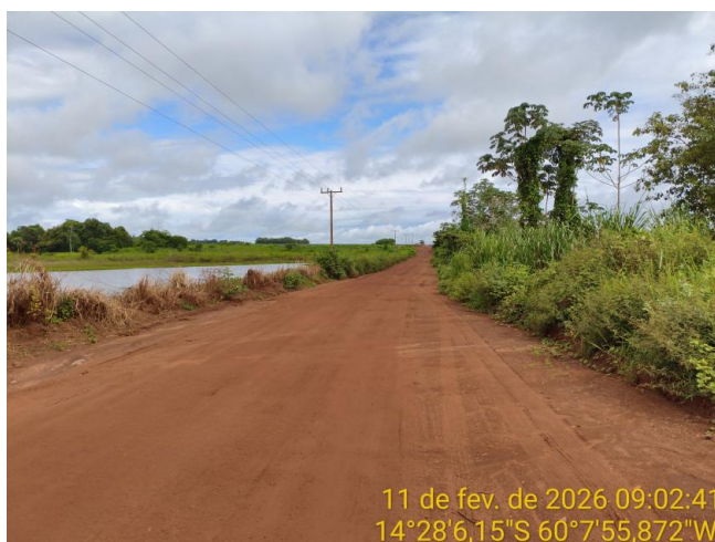
Foto 81 – Trecho não pavimentado da MT-199.
