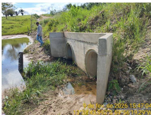
Foto 51 – Bueiro 07 (Boca sem sinistro) na MT-440
