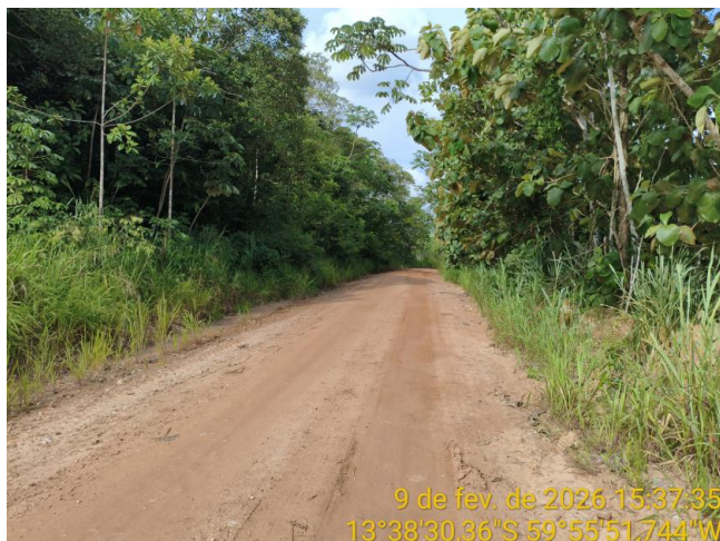
Foto 46 – Trecho não pavimentado de MT-440.
