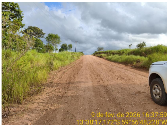
Foto 67 – Trecho não pavimentado da MT-440.
